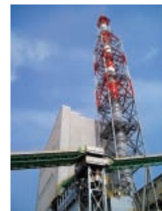
苫小牧工場RPFボイラ
